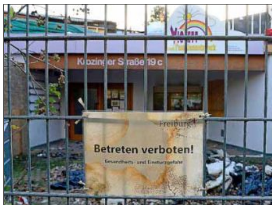
Die Brandfolgen sind am Kita-Stammsitz weiterhin unübersehbar.
