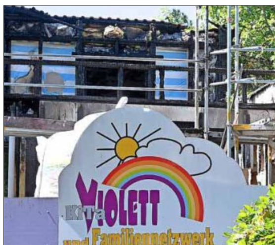
Viel verkohlte Bausubstanz
