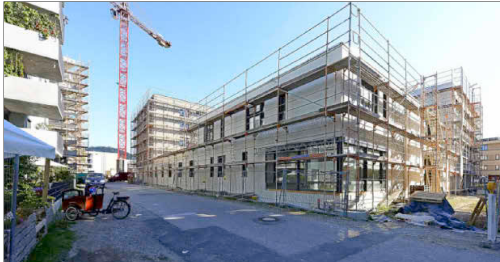
In einem Anbau des gerade entstehenden Gebäudes Magdalena-Gerber-Straße 11, in das auch eine Kita einziehen wird, findet der „Bürgerraum“ für das Quartier Gutleutmatten seinen Platz.
